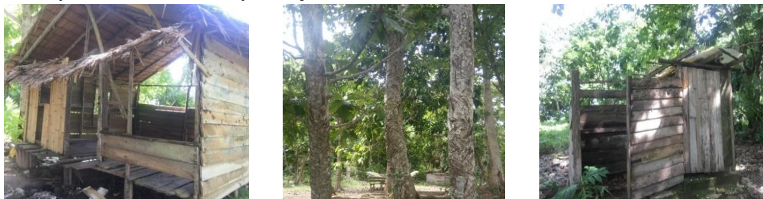
Gambar 8. Fasilitas Penunjang di Pulau Penibung Yang Tidak Memadai (Inadequate Supporting Facilities on Penibung Island)
