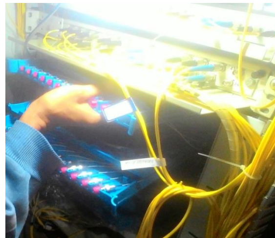
Gambar 1. Optical termination Box (OTB) di STO Pemangkat sebagai Tx.
