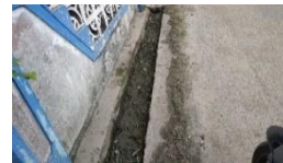
Gambar 11. Kondisi Pendangkalan Drainase di Srikandi 1 (Observasi Peneliti, 2021)
