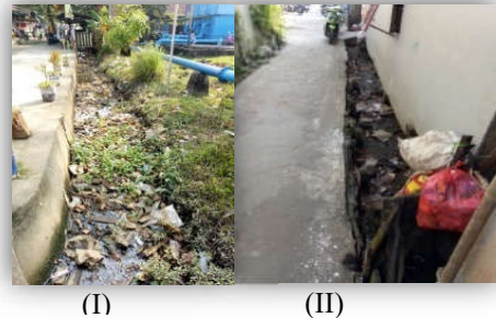
Gambar 4. (i) Kondisi Drainase Jalur 7 (II) Kondisi Drainase Jalur 8 Sumber:Hasil Dokumentasi, 2018
