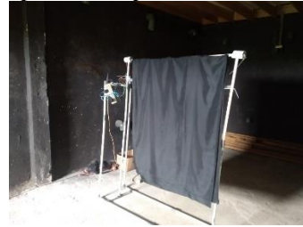
Gambar 14. Implementasi Sistem Pengontrolan Intensitas Cahaya di Dalam Rumah Budi Daya Burung Walet
